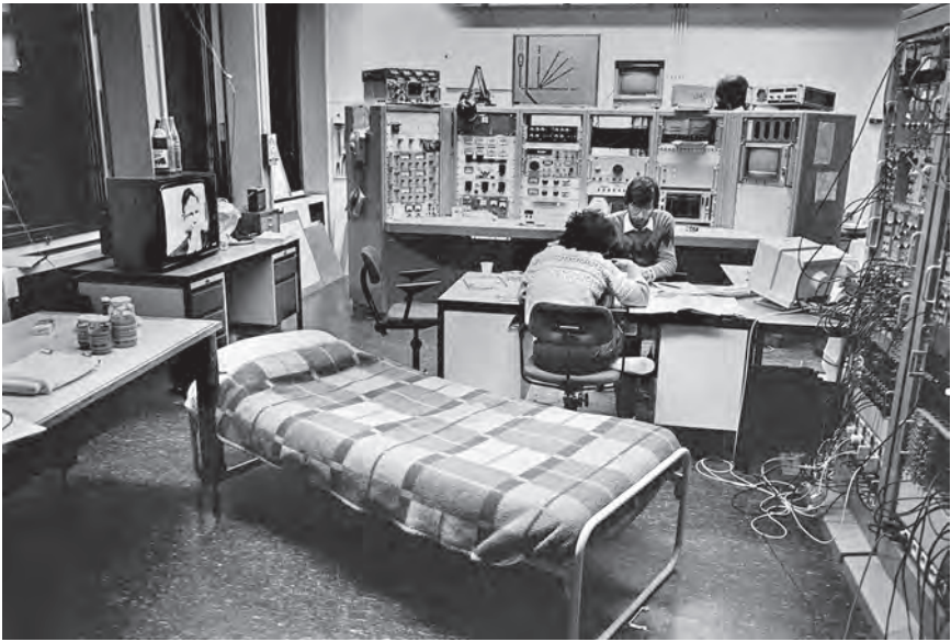
De controleruimte van een 3 MeV-versneller; omdat de apparatuur ook 's nachts in gebruik is, is er een bed aanwezig (foto: Werry Crone).
